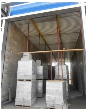
Situation similaire avant accident dans une cellule adjacente
